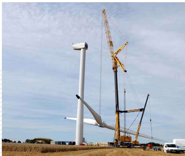
Figure 71 : Photographie du levage d'une éolienne à Flocques dans la Seine-Maritime (source : EDPR)
